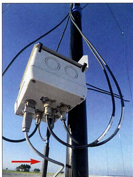
Bild 42: Fertig angeschlossene VDA-Umschaltbox; gut erkennbar sind das ins Shack führende Koaxial- sowie das Steuerkabel.
